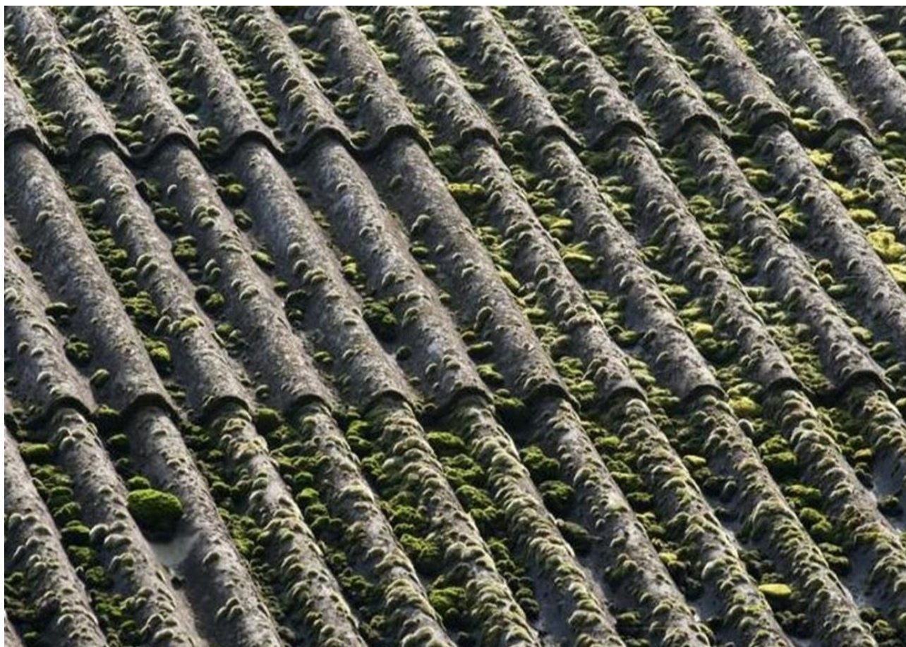
Fig. 8.1 – Copertura di lastre di cemento-amianto colonizzate da muschi e licheni.
